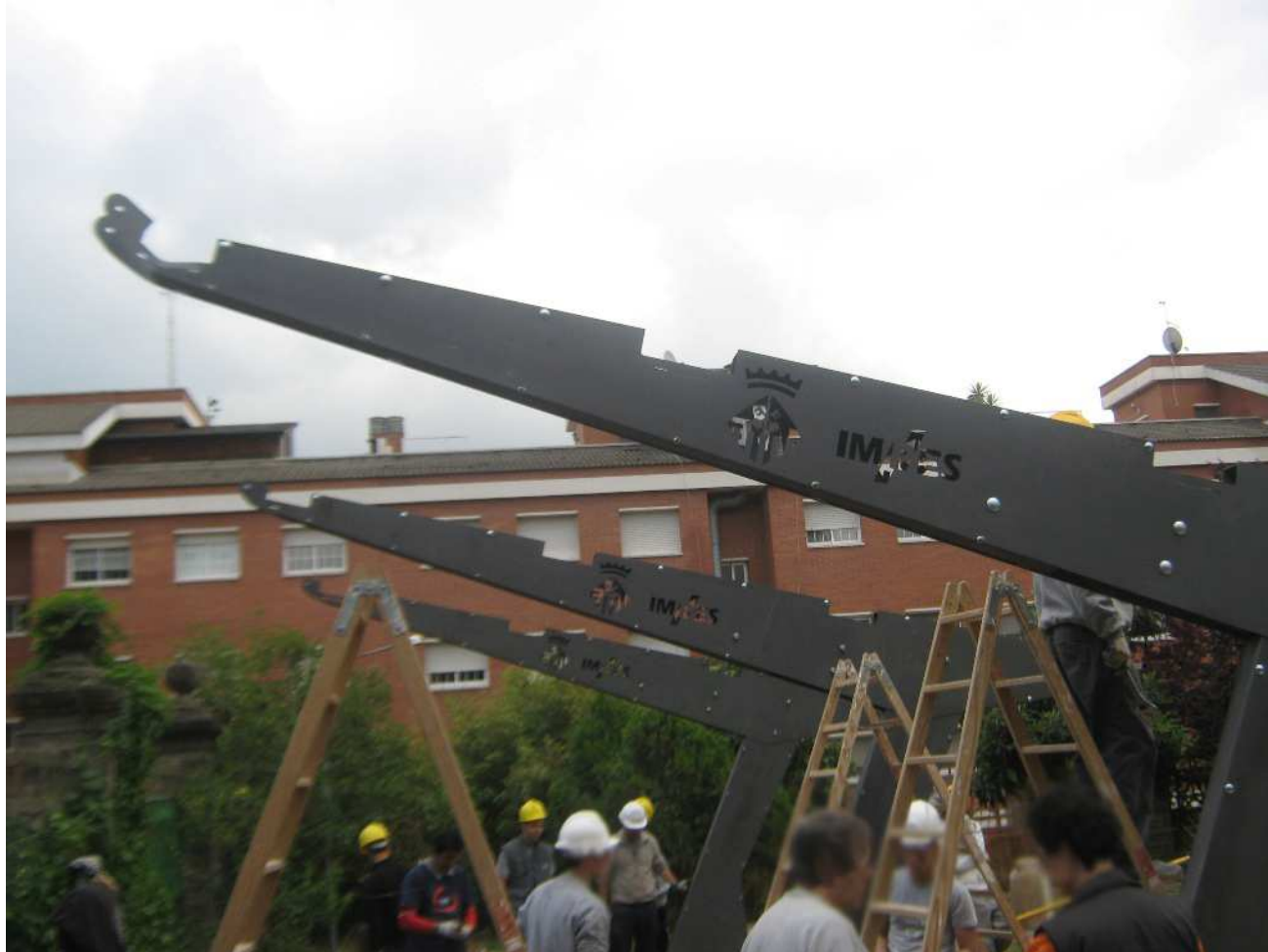
Detall Suport plaques solars (Torre Salduba 2011)
