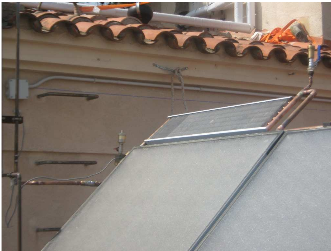
Detall Plaques solars tèrmiques
